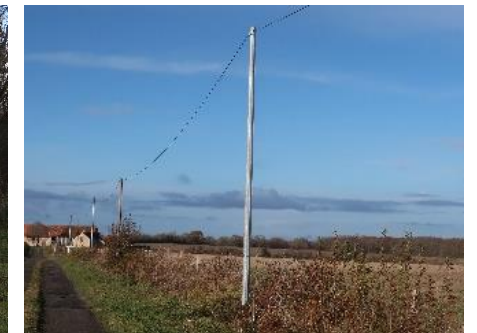
Ligne aérienne Source : ARTIFEX 12/2021
